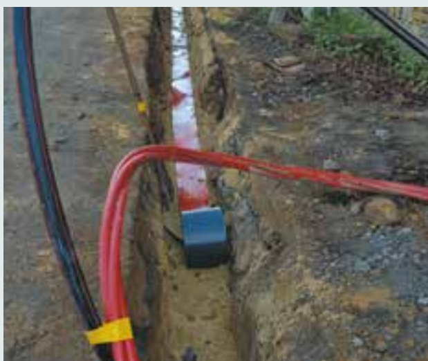
Pose de cables haute tension pour modernisation du réseau - Rue des Aubépines - Ramelot
