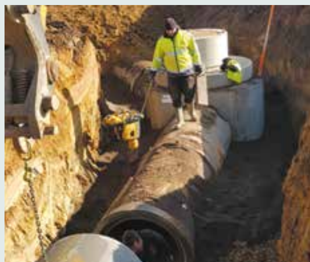
Pose du nouveau réseau d'égouttage dans le lotissement "Terre Bourlotte" à Soheit-Tinlot
