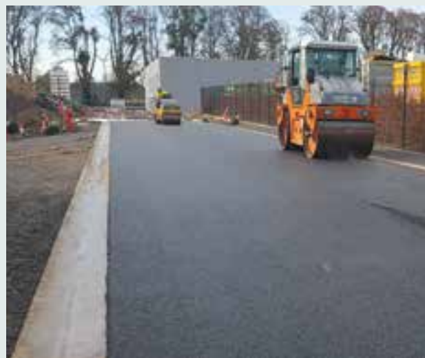
Pose de la couche de finition sur la voirie Bpost - Zoning de Tinlot
